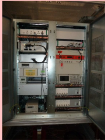
Baie des équipements de contrôle du RFQ cooler
